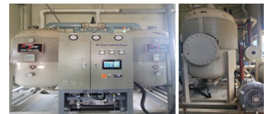
제3공장 에어 드라이어 개선
